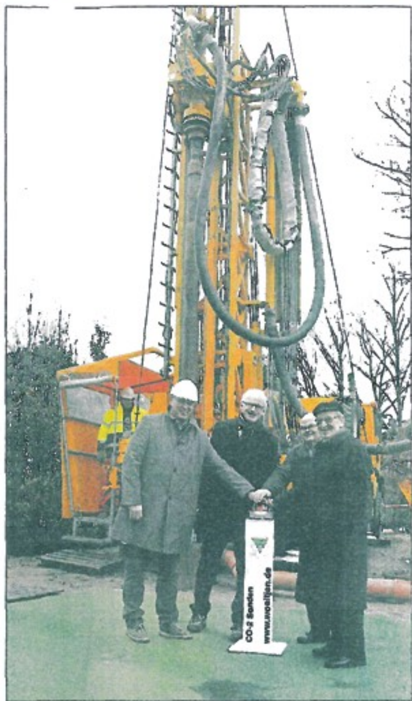
NACH DEM Druck auf den Knopf durch (v.l.) Dirk Fennekoldt, Henning Onkes, Ernst-August Kahle und Dr. Horst Kruse legte der Bohrer los. Fotos: Schmidtzki
