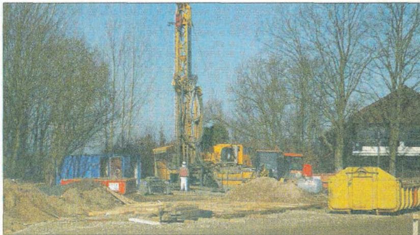
Eine Geothermiebohrung am Nienburger Badstandort erbringt einen Solefund mit hohem Salzgehalt. „Dies könnte ein Indiz dafür sein, dass sich eine solche Bohrung auch in Berenbostel anbietet“, sagt der CDU-Politiker Hartmut Büttner. Foto: r
